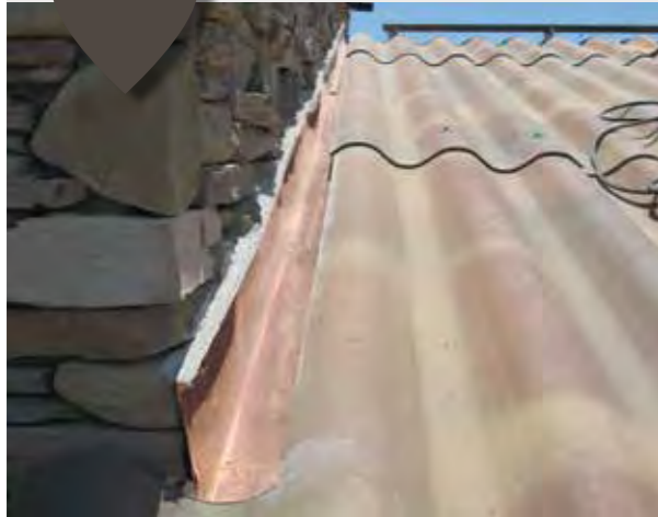
Im Bild ein Beispiel für falsche Installation.
