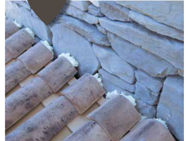
Im Bild ein Beispiel für falsche Installation.
