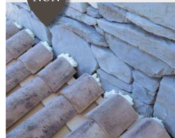
Sur la photo un exemple d'installation incorrecte
