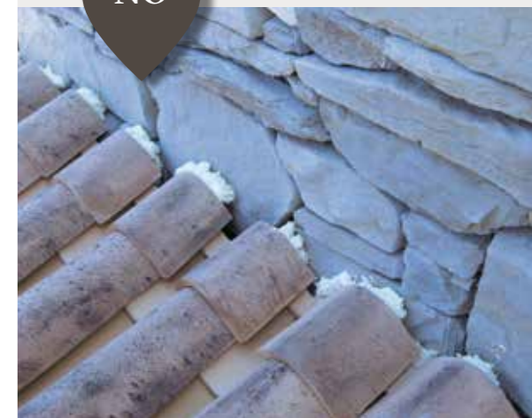
Nella fotografia un esempio di errata posa
